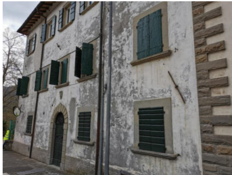
Figura 13. Foto Fonte: Regione Emilia-Romagna sopralluogo 2021
