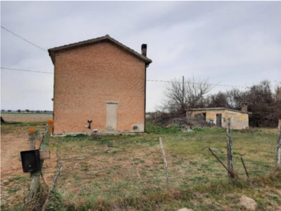
Figura 12. Foto Fonte: Regione Emilia-Romagna – sopralluogo 2022
